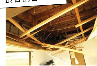
天井全体で天井板が脱落している。
