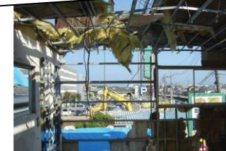
外壁全体で全ての仕上材が脱落している。
