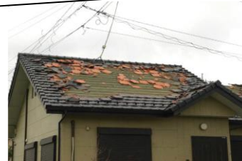
屋根の4割程度で瓦がずれ、破損又は落下している。
