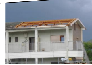
屋根の全体で小屋組の損傷が著しく、葺材の大部分が損傷を受けている。
