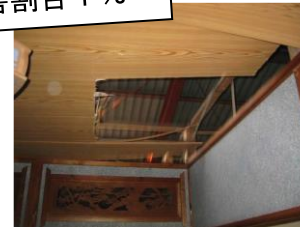
天井の1割程度で天井板がずれ、一部脱落が見られる。
