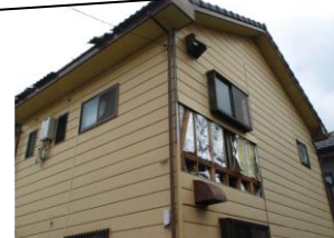
外壁の1割程度で釘が浮き上がり、ボードの脱落が見られる。
